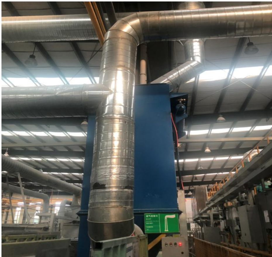
图 3-4 钎焊废气处理设备及排气筒设置情况
