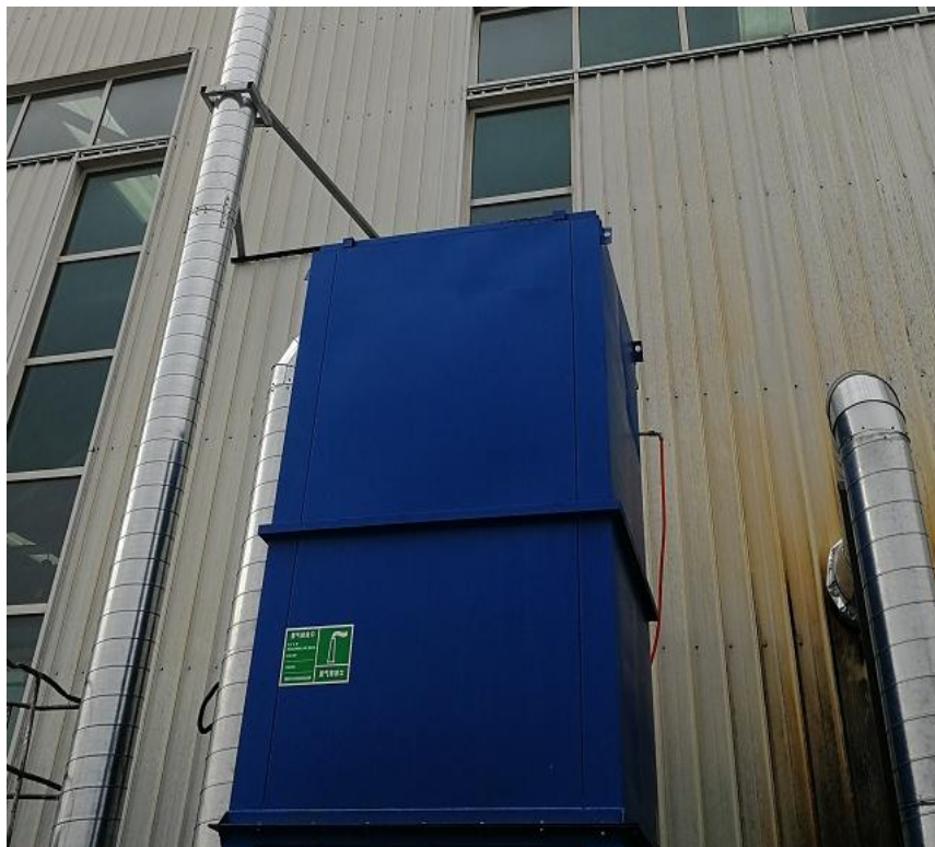
图 3-2 废边角料粉碎废气处理设备及排气筒设置情况
