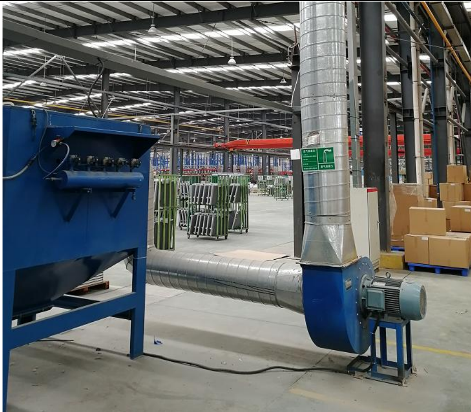
图 3-3 补焊及焊点打磨工序废气处理设备及排气筒设置情况
