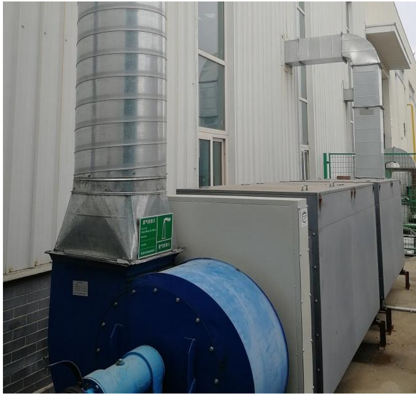
图 3-1 注塑废气处理设备及排气筒设置情况
